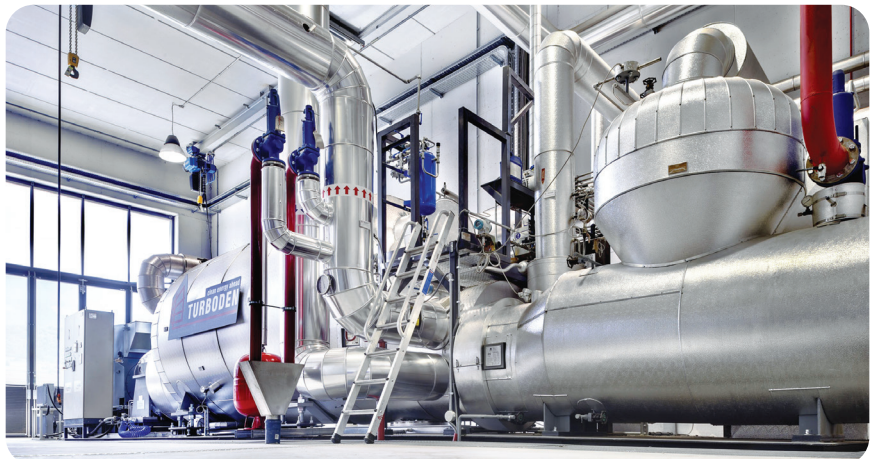
Sistema ORC Turboden per la cogenerazione
